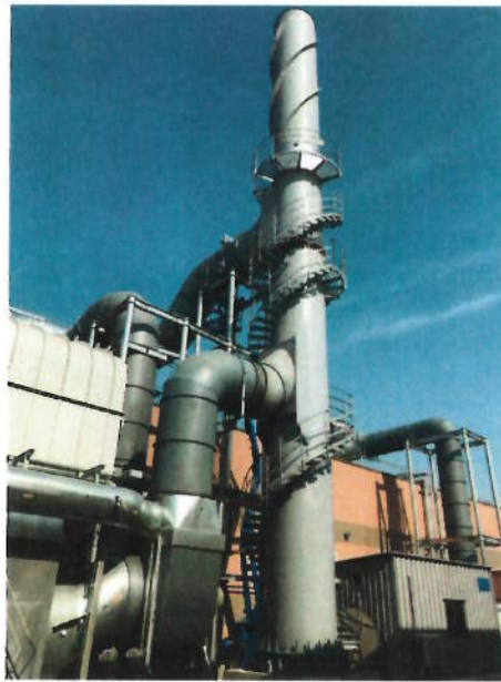
DA019 生产废气排放口
